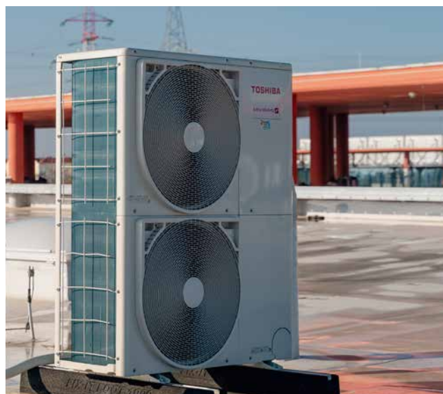
Trgovački centar PADO Shopping Galerien Parndorf, tvrtka CAVERION Österreich GmbH, klimatizacijski uređaji i dizalice topline
