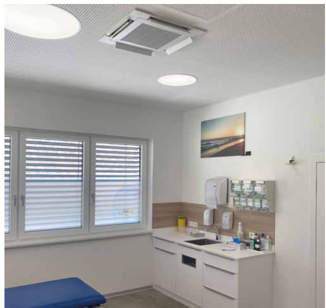
Ordinacija Groß St. Florian, Cool Company Kälte - Klima - Gastro
