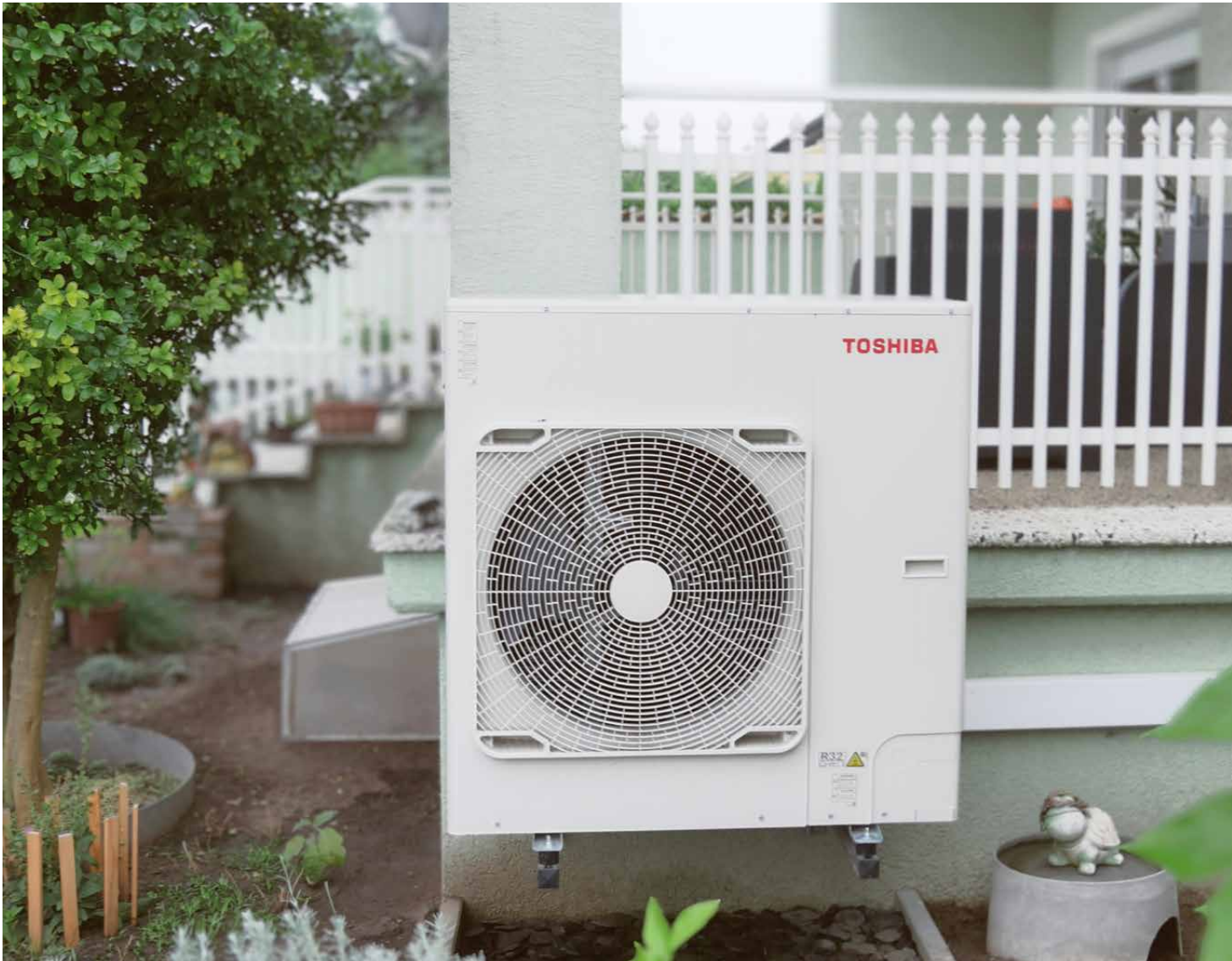
Porodična kuća u Poderzdorfu, Robert Müllner GmbH - Kälte Klima Installateur
